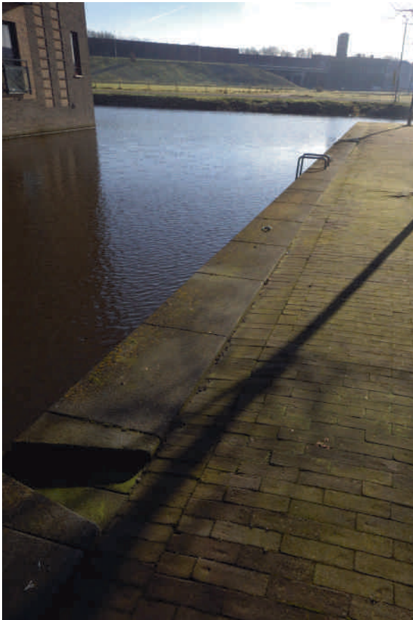
Foto 1 In bouwfase 1 sluiten de meeste kademuren rechtstreeks aan op de bestrating. Bij regen vloeit er daardoor rijkkelijk regenwater over de kademuren.
